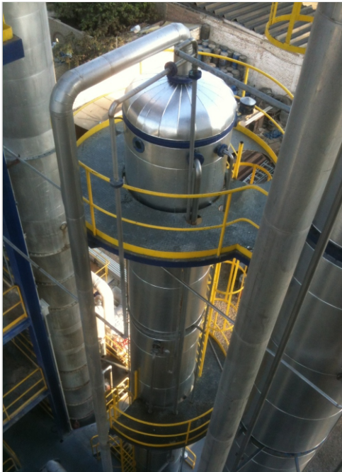
Aislamiento Térmico Columnas de Destilación Agroindustrial Cartavio
